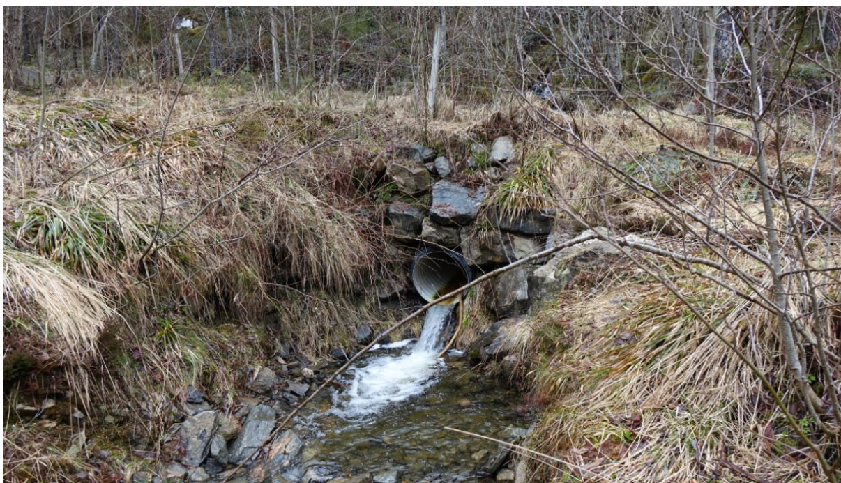
Figur 17: Stikkrenne ved bekkeløp inn i planområdet, GPS-punkt 551. Bekkeløpet inn i planområdet er ikke flomvurdert.
